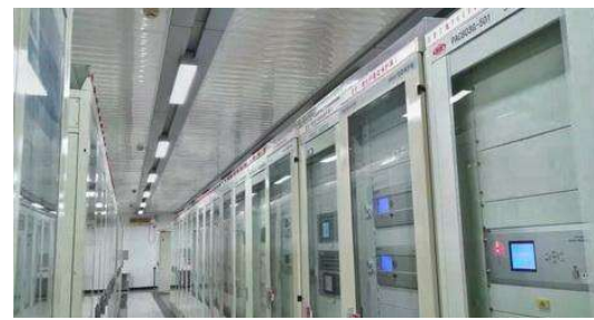
500/750kv超高压继电保护装置
